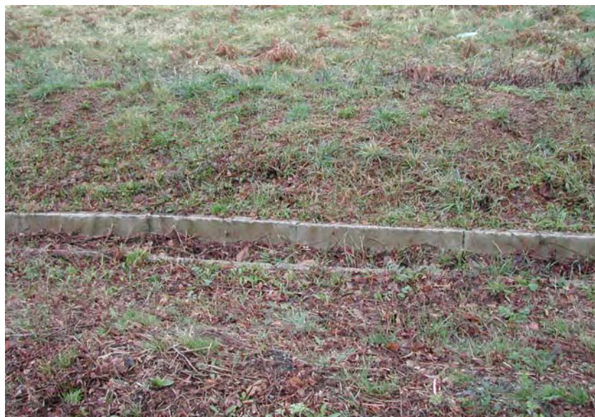
Fig. 36. Demi-buse étanche en bord de route
